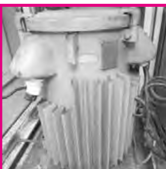
トランス（変圧器）
