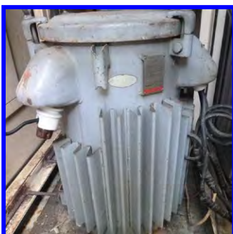
トランス (変圧器)
