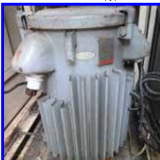
トランス（変圧器）
