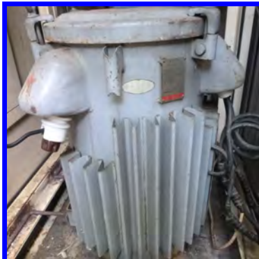
トランス（変圧器）
