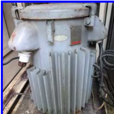
トランス（変圧器）
