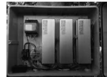
安定器BOXに収納された安定器
