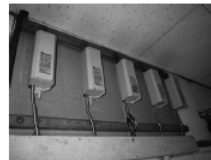
工場等の壁際に設置されている例
